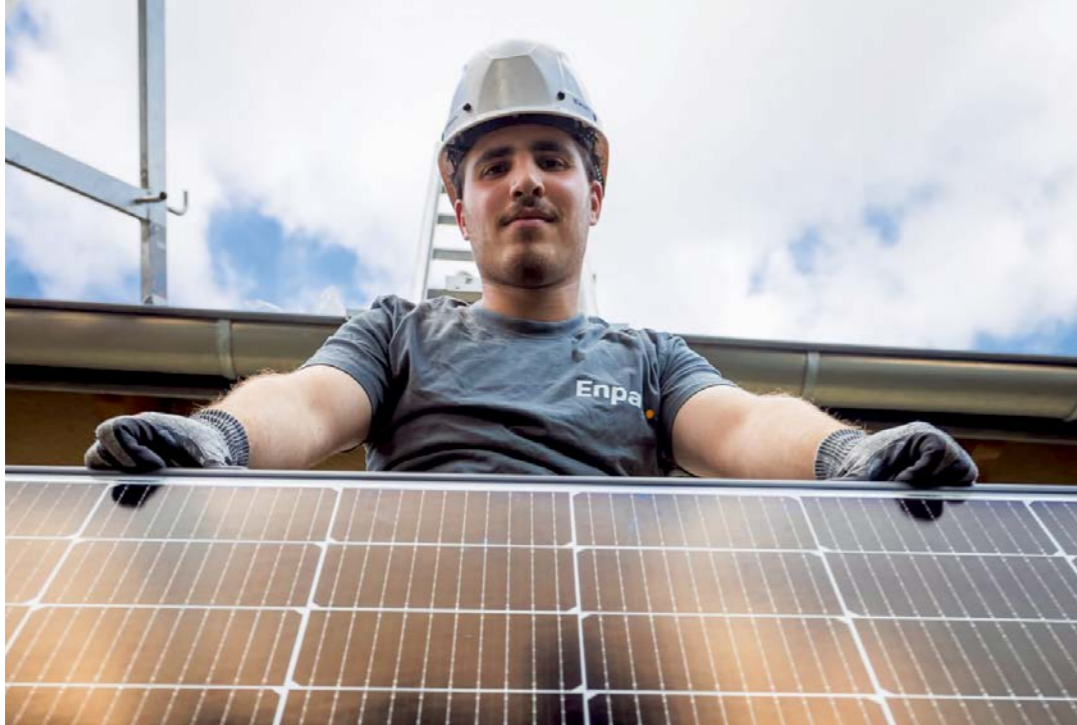
STROM VOM DACH: Die Berliner Enpal ist Spezialist für Wärmepumpen und besonders bekannt im Bereich Photovoltaik-anlagen
